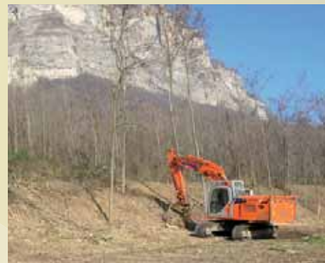
Les services municipaux entretiennent régulièrement les digues afin qu'en cas de chutes de blocs, elles jouent leur rôle de manière efficace.
